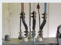
周囲温度上昇による トランスの異常発熱
